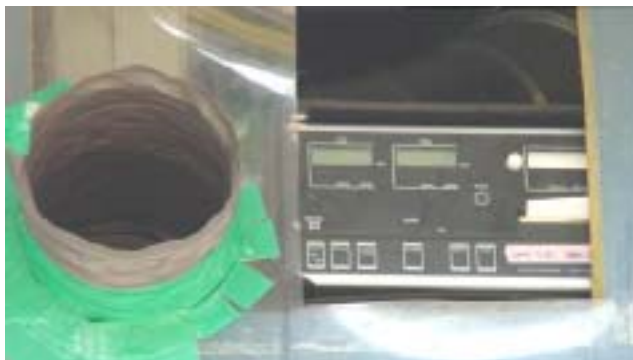
(그림 3.10) 배기덕트에 설치된 CO 2 측정기기
